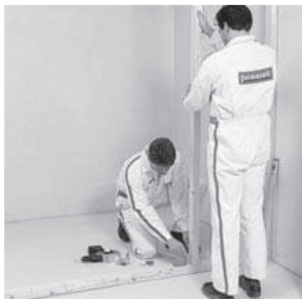
Montage et fixation des montants bois avec fixation par clous et équerres métalliques
